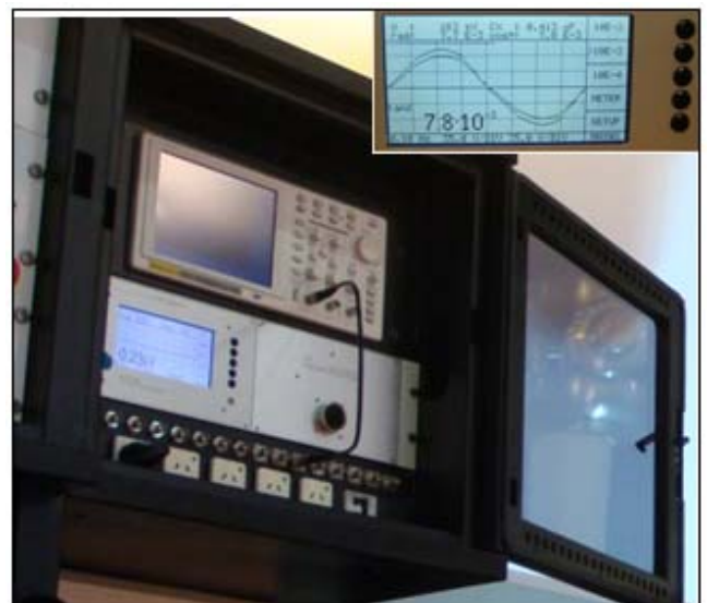
Panel de Medición de DP del Sistema VLF-200 HVCD
