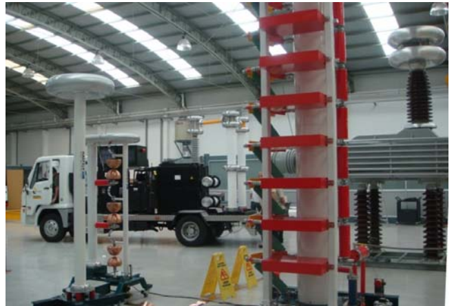
Sistema Móvil VLF-200 HVCD durante las pruebas de conformidad
