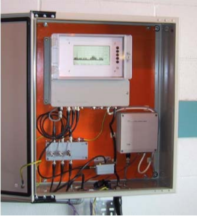
Figura 12- Unidad ICM Monitor, instalada en un gabinete con módem, caja de terminación, y HF CT para captura de ruidos.
