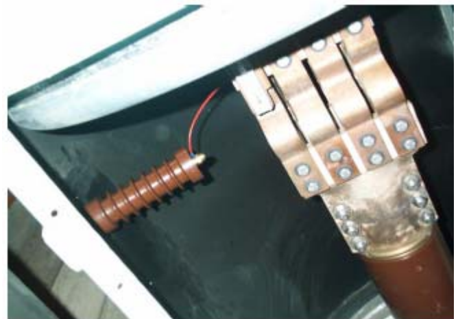
Figura 11- Capacitor de acoplamiento instalado en el flex link de un generador de turbina de 300 MVA.
